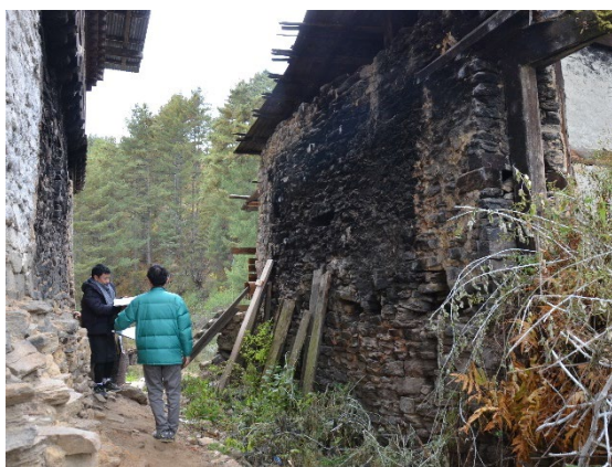
写真 30 南外壁の煤けと旧戸口
