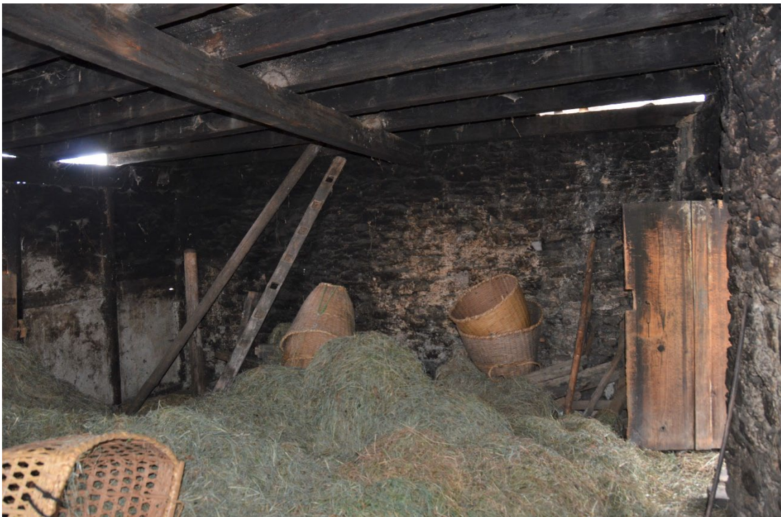
3-6 ソナム.ガンモ邸 2階内部（現飼料小屋・元居間兼厨房） 北西から
