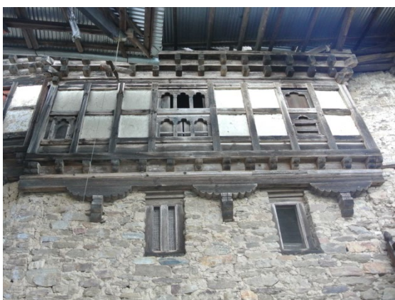
写真 28 閉塞痕跡がある 2 階南面中央部の外壁
