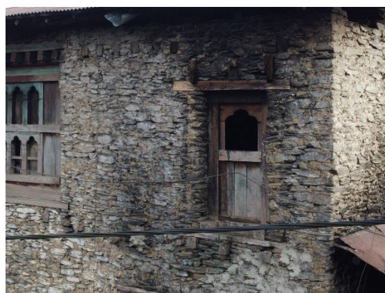
写真 21 背面の張出し痕跡
