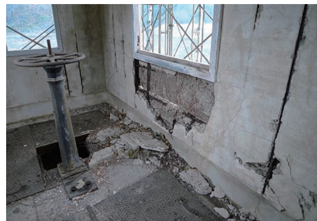
photo 4-3: Deteriorated and damaged internal walls of No.2 intake water control gate shed (reference : 『重要文化財 旧美敷水源地下水道施設 保存修理工事報告書』、p.95)
