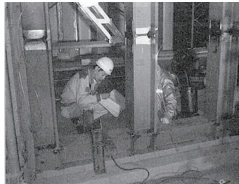
photo 9 Vertically latticed steel frames (reprinted from 『早稲田大学大隈記念講堂保存再生工事報告書』(早稲田大学、平成 20 年 (2008) 3 月) P.209)
