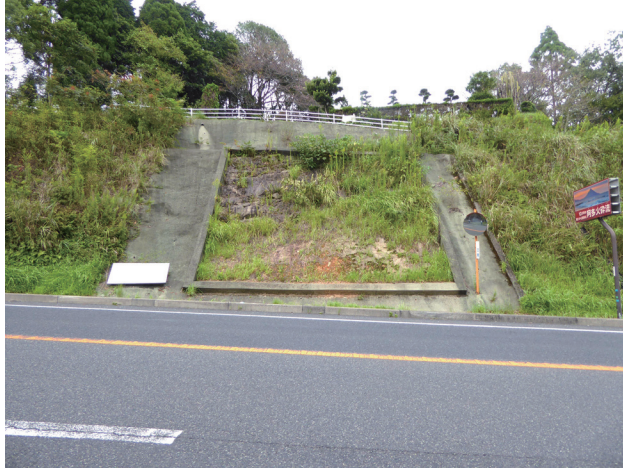
図1 保存公開が試みられた火砕流堆積物露頭の公開5年後の状況 既に地層を全く確認できない状態となっている。
