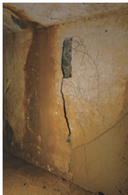
Fig. 2-13 石材表面からの漆喰層の剥離
