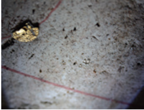
Fig. 2-6 天井から剥がれ落ちそうな金箔
