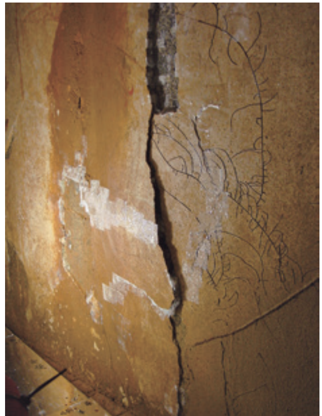
Fig. 2-18 東壁の漆喰層の剥離（応急処置後）
