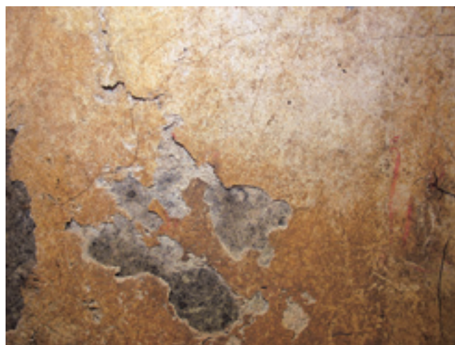
Fig. 2-23 亥像の周りの漆喰層の浮き上がり
