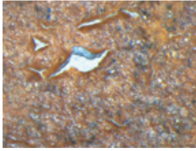
Fig. 4-29 クリーニング処置前（バイオフィームに引っ張られて表面が剝離し、下層の白い漆喰が見えている。）
