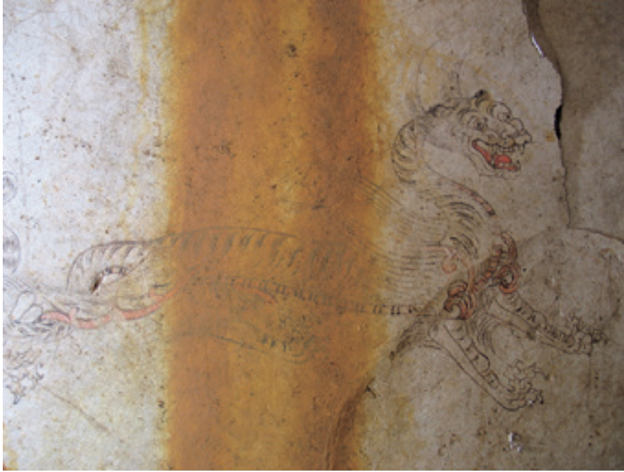
Fig. 2-19 西壁の漆喰層の剥離（白虎像周辺）
