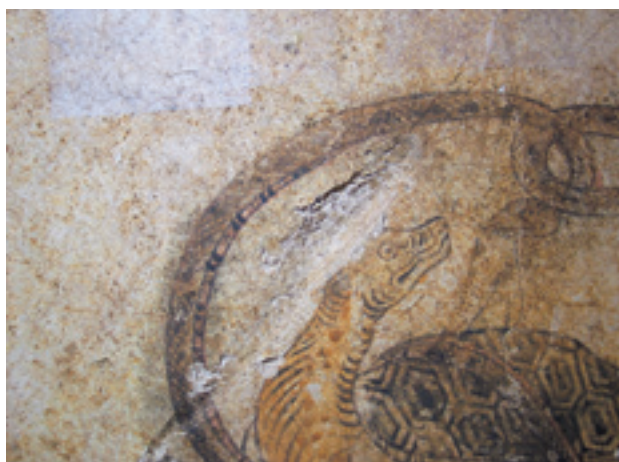
Fig. 2-24 北壁(玄武像上部)の損傷
