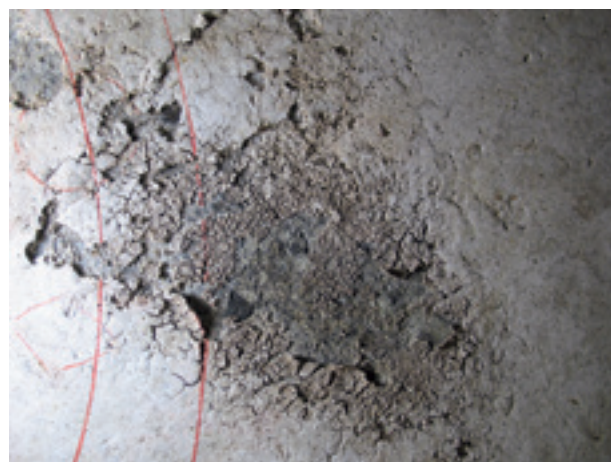
Fig. 2-25 天井の漆喰の粉状化(天文図、北西付近)
