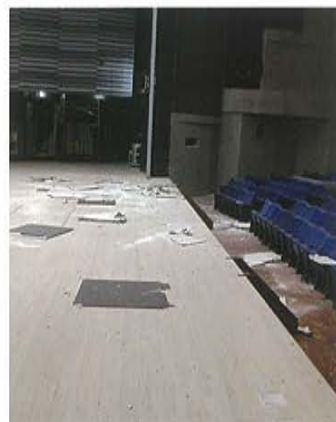
石膏ボードが剥離・落下し、舞台・客席へ散乱
