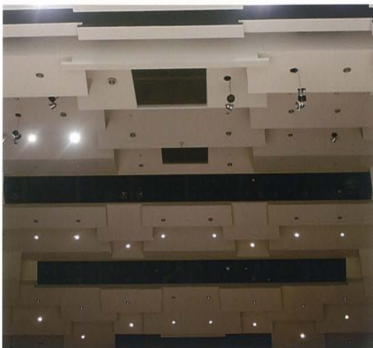
リアスホール、大ホールの照明が天井よりぶら下がる
