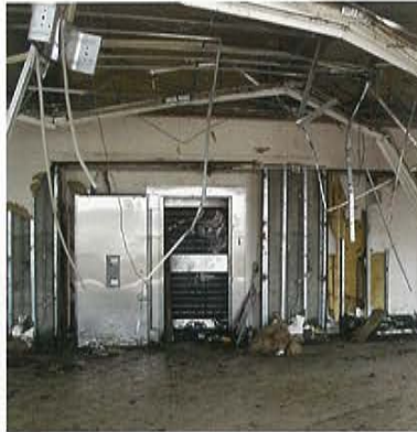
自衛隊により瓦礫などが撤去された後の館内（1階）
