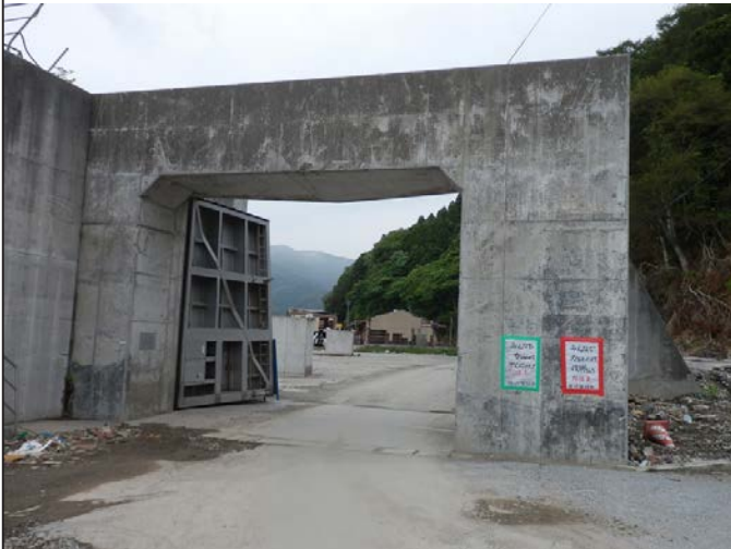
図8 田浜の防潮堤
