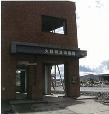
被災した大槌町立図書館（外観）
