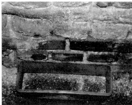
旧下野煉化窯におけるレンガの劣化
