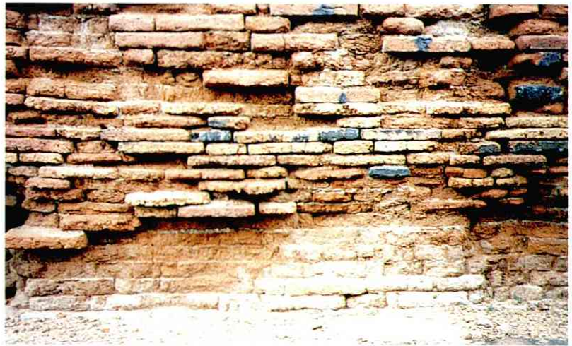
アユタヤ遺跡におけるレンガの劣化（マハタート寺院）
