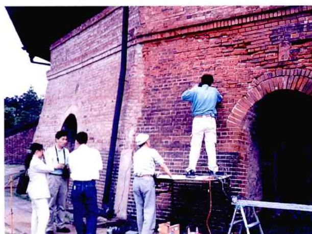
ホフマン式輪窯劣化状況調査（30頁参照）
