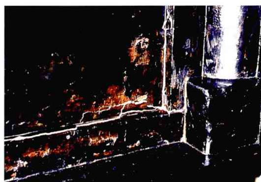
漆膜に生じた亀裂
