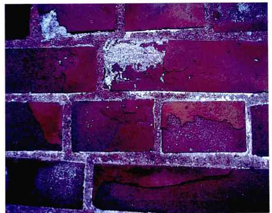
旧下野煉瓦窯における塩の析出によるレンガの表面崩落
