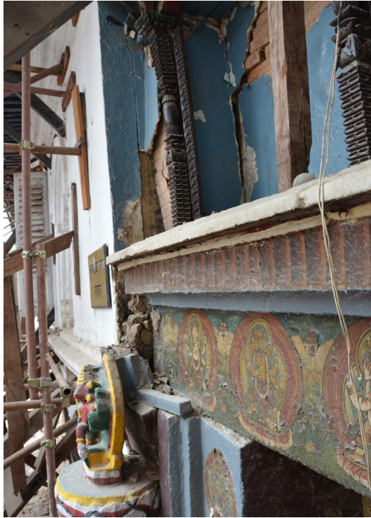
図3-1-20 ハヌマン門上部の破損状況
