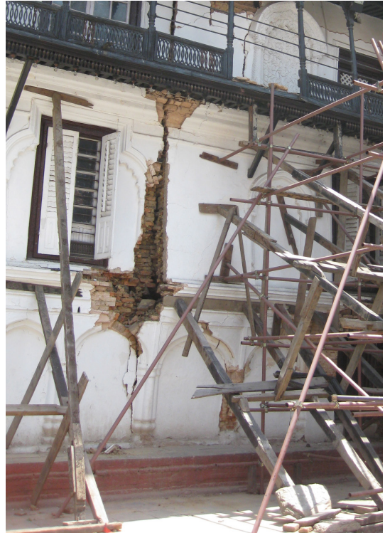
図3-1-13 アガンチェン寺直下西外壁面に生じたずれ
