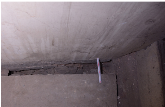
図3-1-22 ハヌマン門上3階床と西側外壁間に生じた空隙
