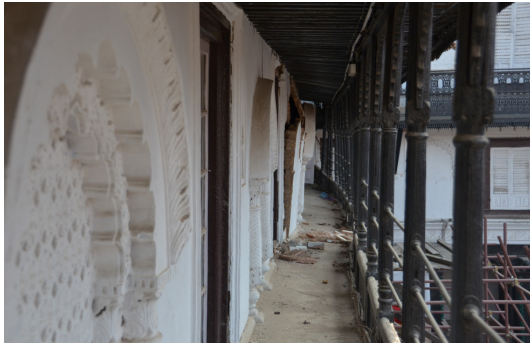
図3-1-14 モハン・チョク西棟3階西面バルコニーの破損状況
