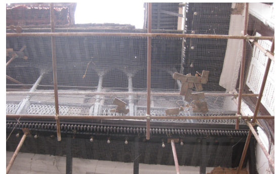
図3-1-23 ハヌマン門上の屋根から落下した瓦片
