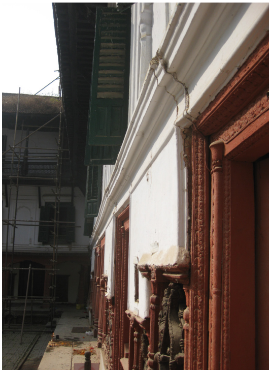
図3-1-18 モハン・チョク西棟東面の変形状況
