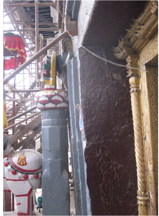
図3-1-21 傾斜したハヌマン門北側門柱
