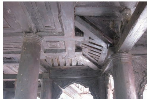
写真33 塔初層・桁端部の撓み(インワ・バガヤ僧院)
