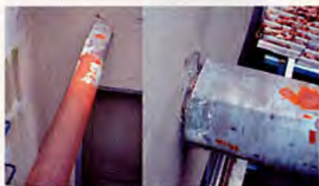
排水管の破損
