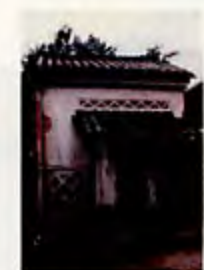
外壁のシミ（建物内高湿度の要因？）
