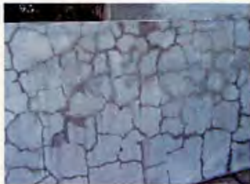
外壁の亀裂（雨天後がわかりやすい）
