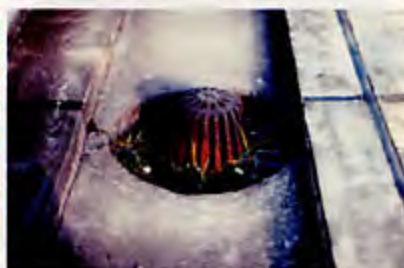
排水溝の目詰まり
