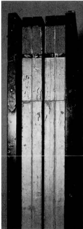
82 修理前 金具が欠失し、尾背には虫損が見られる。 Before restoration Missing metal ornaments and insect damage along the hinges.
