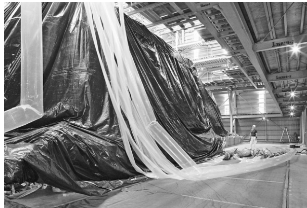
写真6 本堂の被覆と排気チューブの状態
