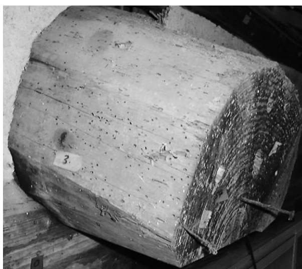
図5 マツ材の小屋梁に発生した甲虫による食害の痕跡
