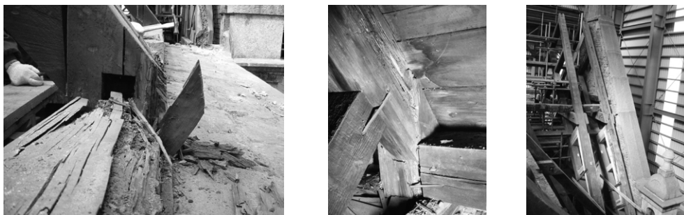
図15 煉瓦造の壁上縁での小屋組材の劣化事例
