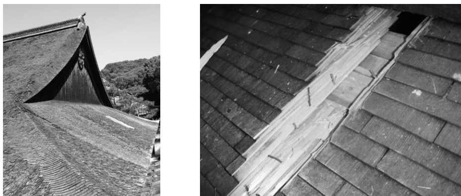
図11 葺き替え後40年以上経過したこけら屋根(左)と妻面におけるこけら屋根の内部の状態(右)
