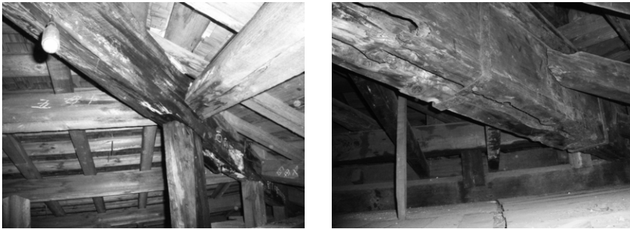
図8 隅木周りに見られる腐朽の例
