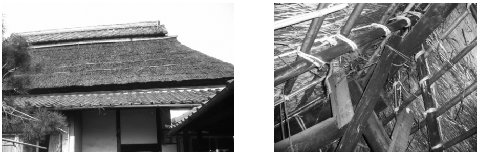
図14 瓦棟の載った茅葺き屋根（左）と小屋組材の破損および補強状態（右）
