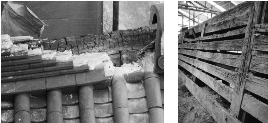
図9 棟木（左）および箱棟（右）の腐朽事例
