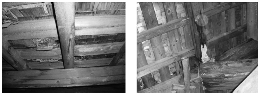
図3 野地から浸潤してきた水分で発生した小屋組部材の腐朽
