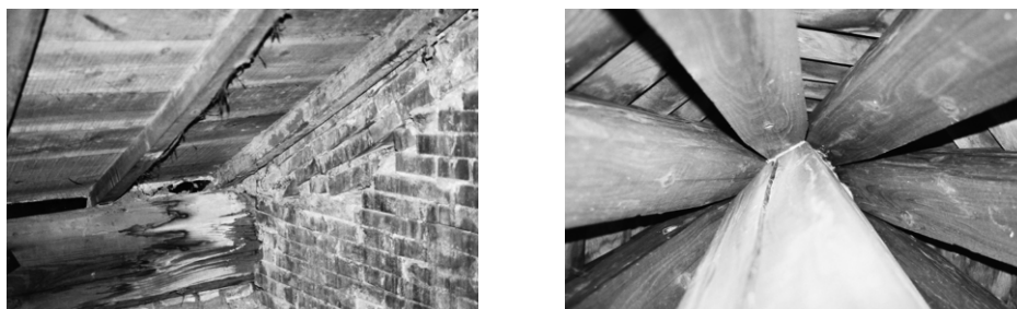
図16 煉瓦造の教会礼拝堂での腐朽事例(左)と鐘樓にまで伸びた蟻道(右)
