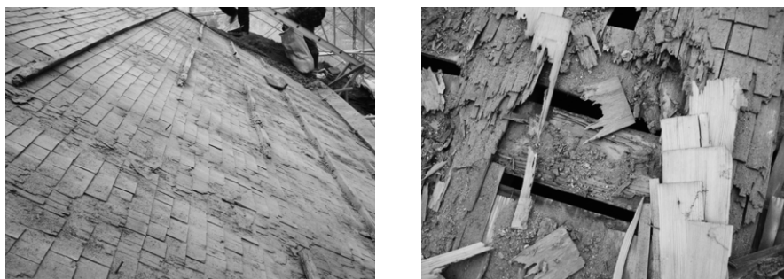
図2 瓦屋根の下地部分（土居葺き）に見られる腐朽と蟻害
