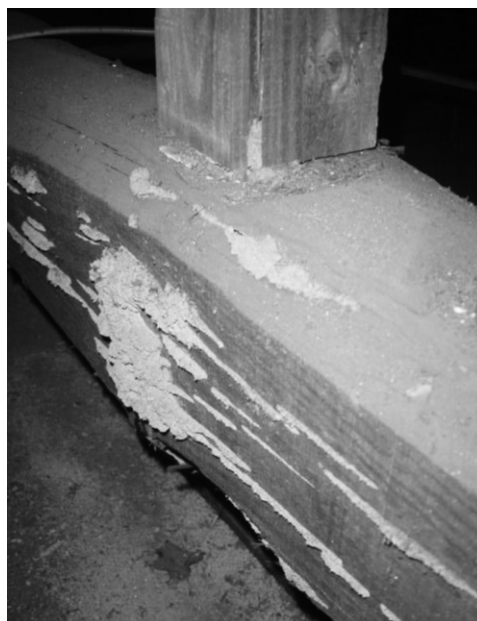
図4 小屋梁に発生したシロアリ食害
