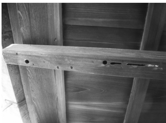
図6 垂木に発生したクマバチによる食害の痕跡
