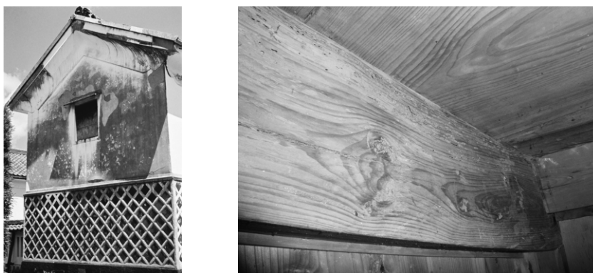
図10 土蔵の外壁の劣化と小屋組材の蟻害の例
