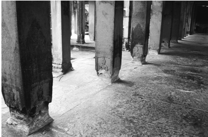
図8. 根腐れ現象の例(東南アジアの砂岩製遺跡にて)
