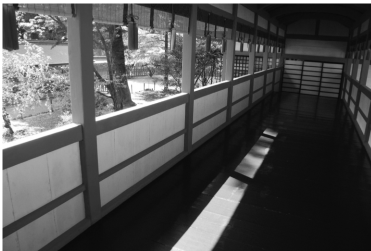
写真1 霧島神宮渡廊下(内側の白色塗装部にてカビ発生がみられる)
