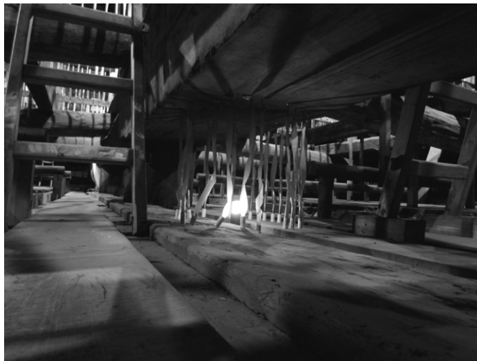
写真6 Uエリア（三仏堂小屋裏，牛梁の下）に設置したLEDライト 2011年7月22日よりLEDライトを設置（24時間連続照射）。
