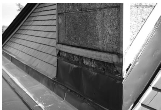
図12 北面の煙突周辺の劣化 (2010年7月13日撮影)
