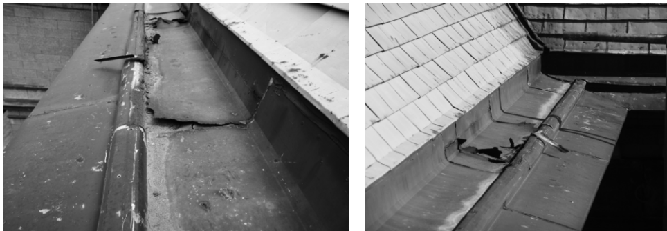
図11 西面の陸屋根でみられる陸樋の破損状況 (2010年7月13日撮影)
