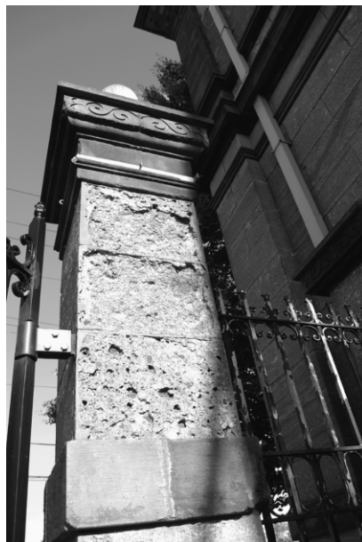
図9 付属石門の劣化 (2010年7月13日撮影)
