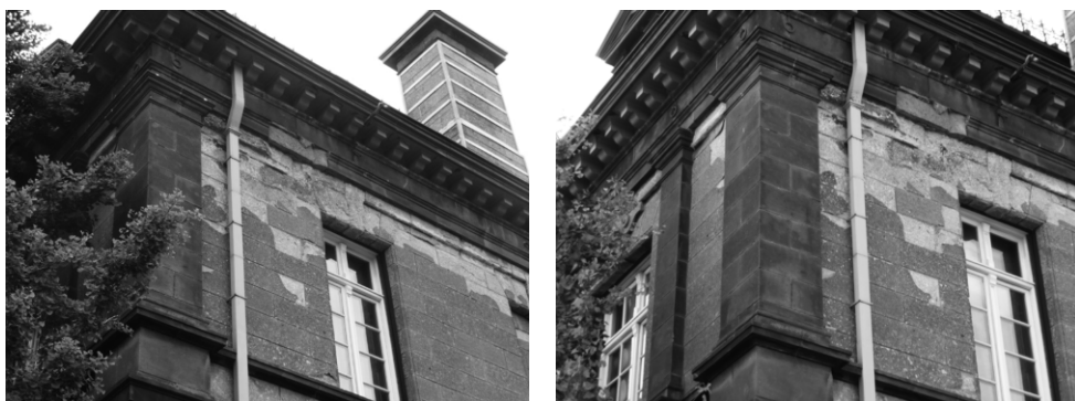
図2 北面と東面の劣化（左：2009年6月30日撮影，右：2011年10月28日撮影）
