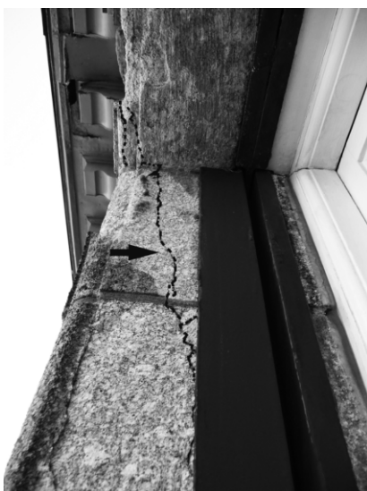
図3 北面の外壁（小樽軟石）で見られる亀裂（破線）と軒天井の破損（2011年10月28日撮影）
