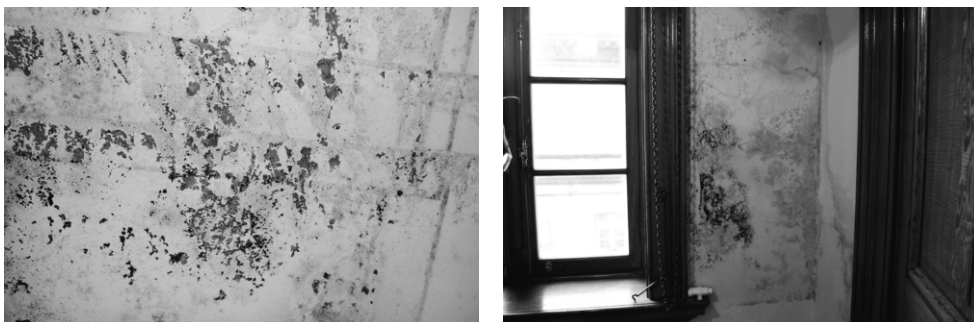
図16 貴賓室の北面の金唐皮紙全剥離後（左）や3Fへの階段踊り場横（右）の漆喰壁でみられる黒カビのコロニー（左：2010年7月1日撮影，左：2011年7月16日撮影）
