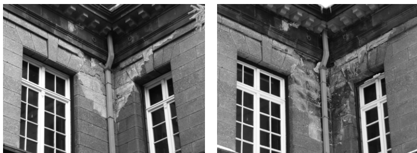
図7 西面南角の劣化(左：2008年11月13日撮影，右：2011年12月11日撮影)
