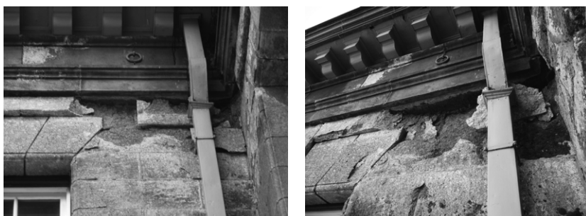
図8 西面で見られる軒蛇腹直近の小樽軟石の剝落・濡色と軒蛇腹の登別産石の濡色 (左：2009年3月18日撮影，右：2011年10月28日撮影)
