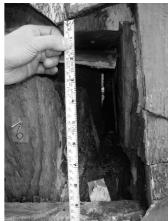
写真2 南西袖柱の根継ぎ周辺空隙
