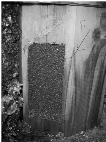
写真10 樹脂充填材料表面の白色液状物質
