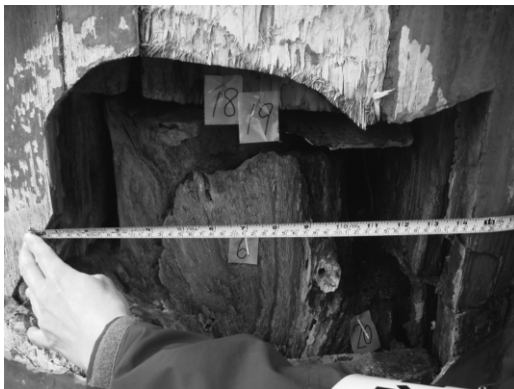
写真1 南西袖柱の根継ぎ周辺空隙
