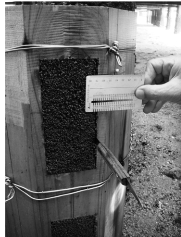
写真9 現地曝露1ヶ月後に生じた新材と樹脂充填材との間隙
