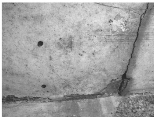
写真5 2005年9月29日 天井の穴(直径およそ1cm)の例
