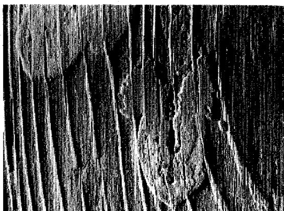
図一17 支輪板(A) 板表面の風蝕
