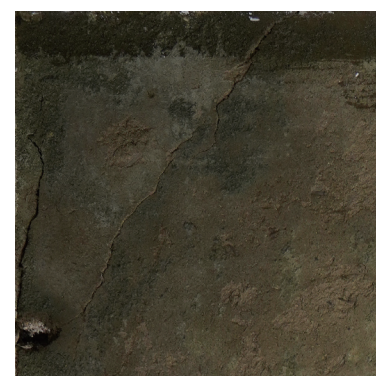
写真 13 発生した大きなひび割れ [撮影：筆者]
