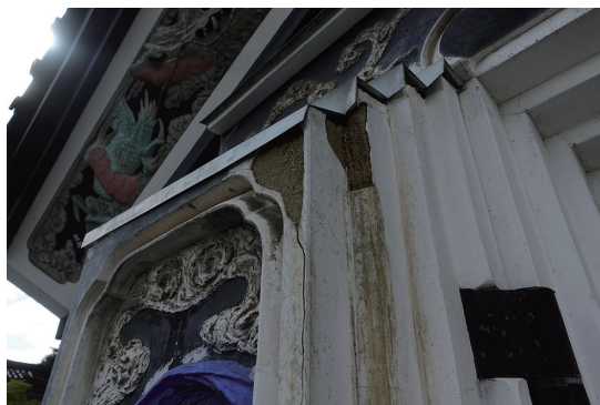
写真24 漆喰の剥落と流れ出た土壁材 【撮影：筆者】
