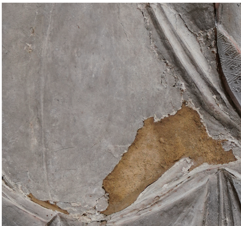
写真 11 漆喰剥落による下地材の露出 [撮影：筆者]
