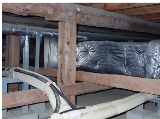
写真 大広間床下に設置された空調用ダクト
