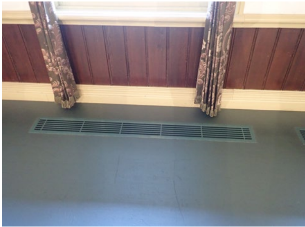
写真 旧善通寺偕行社（大広間内の床面空調の吹出し口）
